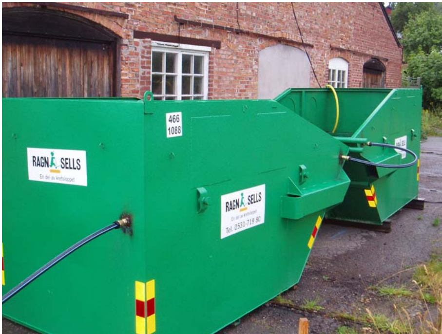
Figur 2. Sedimentationsanläggning bestående av två containrar.
