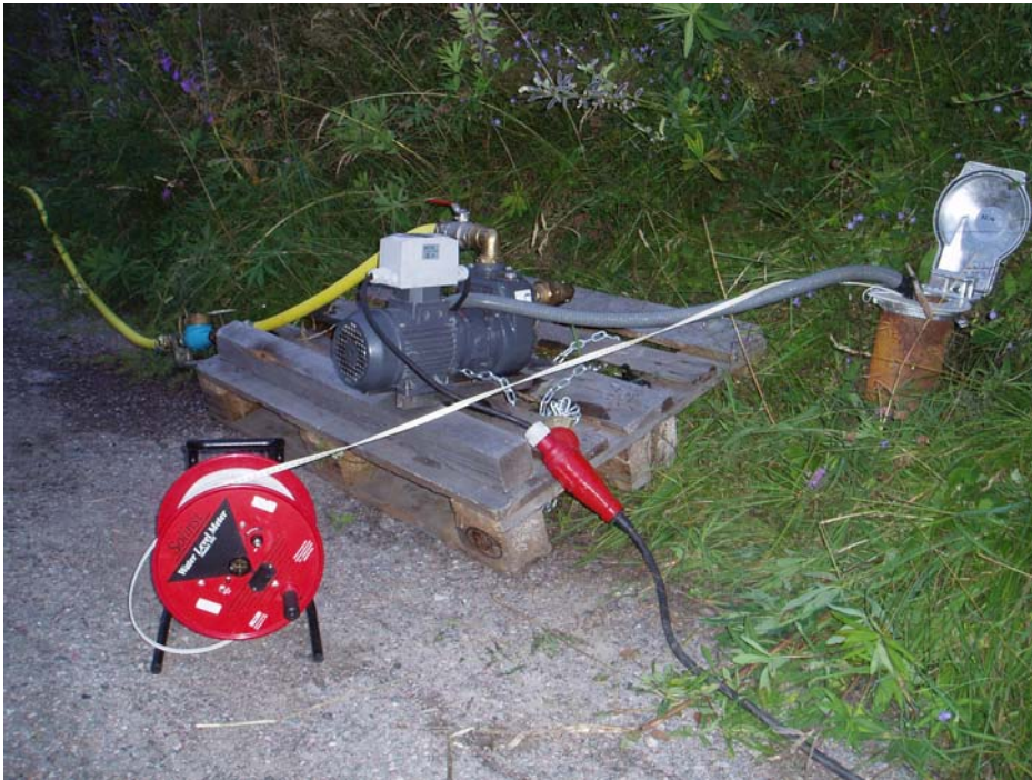
Figur 1. Vid pumpningen användes en sugpump från ABS-pumps, nivåer övervakades förutom med automatloggarar även manuellt med ljuslod.
