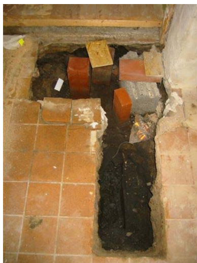
Figur 2 Hål i golvet i BYG B b
