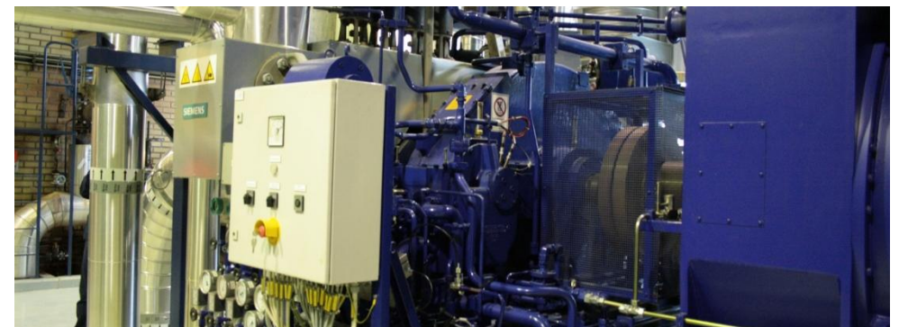
Fjärrvärmeanläggning Billingsfors bruk
