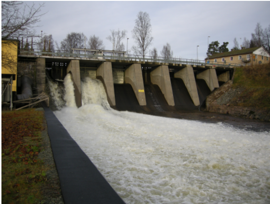
Foto inifrån planområdets nordöstra del som visar befintliga förhållanden för vägbron över utskovsdelen med vänster vattenränna i förgrunden
