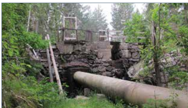
Dammen som dämmer upp Lill-Erven med tuben som för vatten till kraftstationen längre ned.
