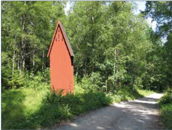
Transformatorstationen vid väggkanten, sedd österifrån.
