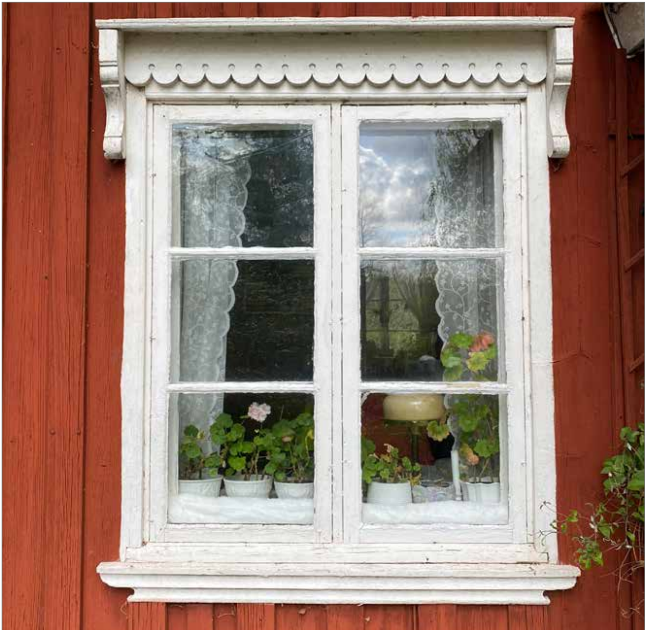
Omsorgsfullt utformade fönsteromfattningar är typiskt för byggnadskulturen i norra Dalsland. Just denna variant med bågformig ornamentik förekommer sannolikt bara i Ärtemark.
